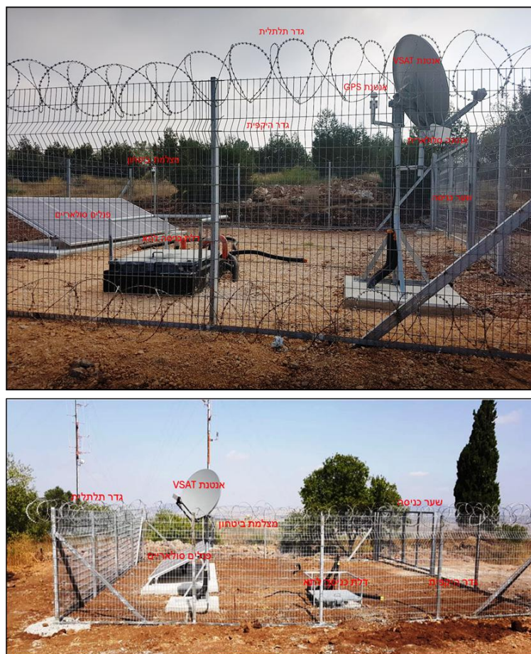
איור 2: אתר תרועה טיפוסי
